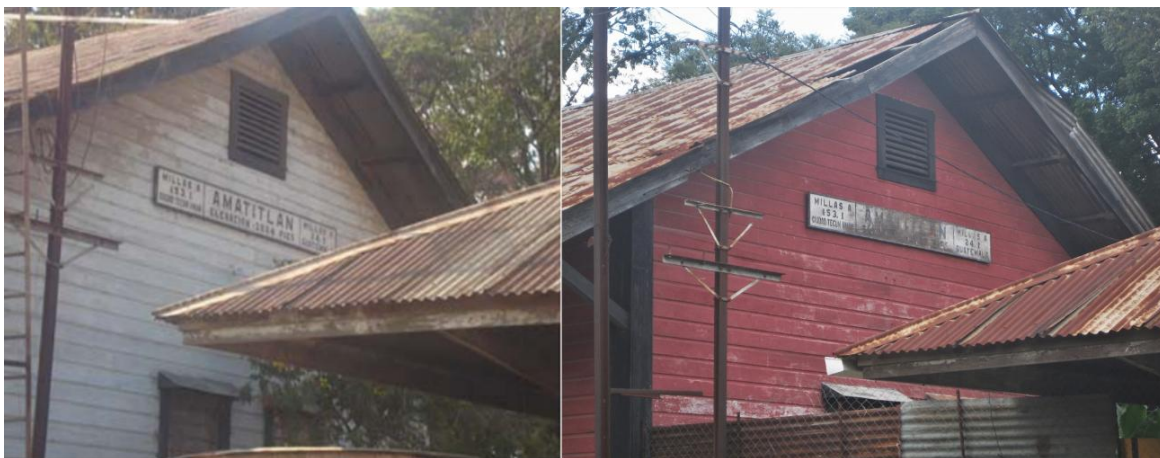
Figura 7. Izquierda: letrero de la estación aún legible. Tomada de Socop Mijangos, 2008. Derecha: letrero en mal estado de conservación y espacio cerrado entre estación y sala de espera. Fotografía: Javier Chaluleu, 2018.
