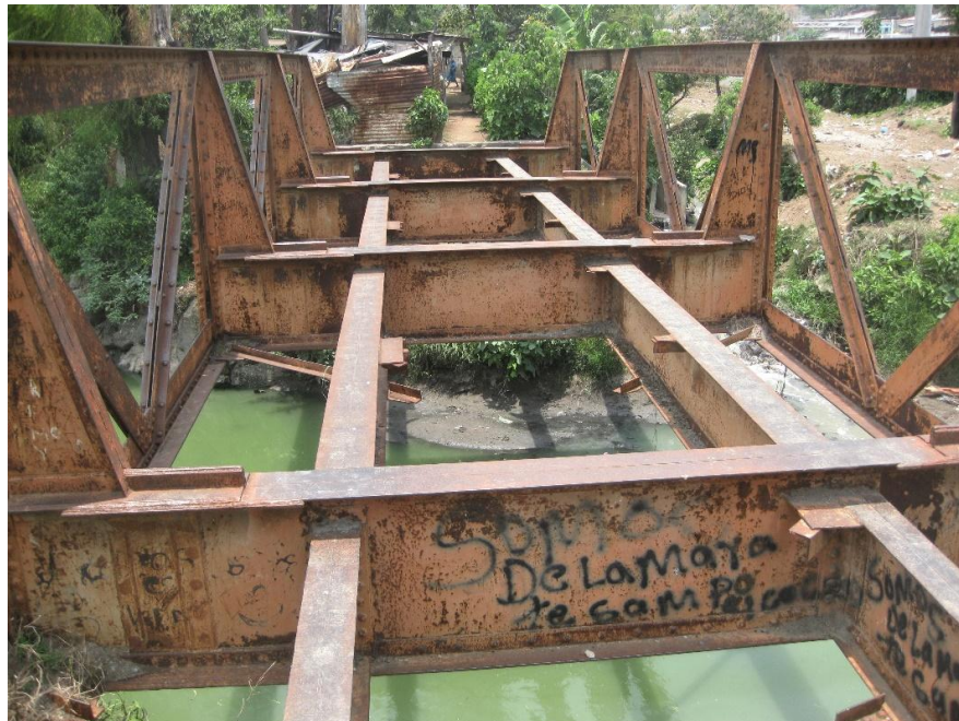
Anexo 3. Estado actual del puente que cruza el río Michatoya. Fotografía: Javier Chaluleu, 2019.
